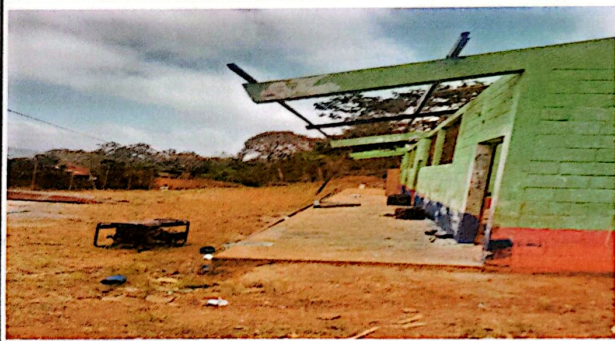
foto 1: se observa que se quitaron las laminas porque estaban en deterioro.
